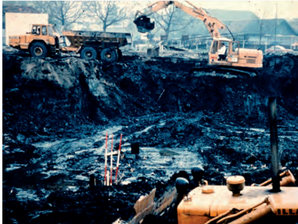
重度に汚染された土壌、オランダにて。掘削による回復が必要。
